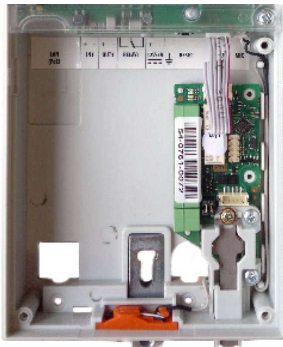
Obrázek: Montáž ochranného spínače
